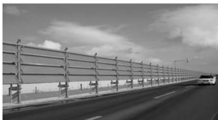
汎用タイプ設置状況
